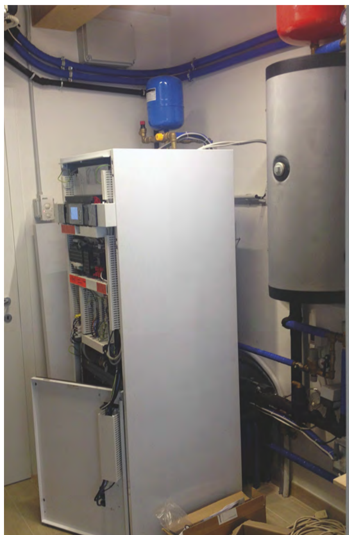
IL LOCALE TECNICO durante l'allestimento degli impianti: nella foto la pompa di calore da 10 kW con bollitore integrato da 170 l per l'ACS, alimentata dal campo fotovoltaico posto sulla copertura.
