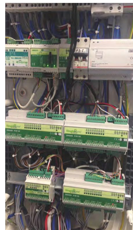
IL SISTEMA DOMOTICO consente la gestione, anche in remoto, delle principali funzionalità dell'edificio: climatizzazione gestione dei carichi elettrici autoprodotti, controllo dei frangisole mobili e della sicurezza.
